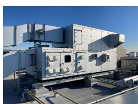
高効率空調機+CO2センサーで外気量制御（空調機）
