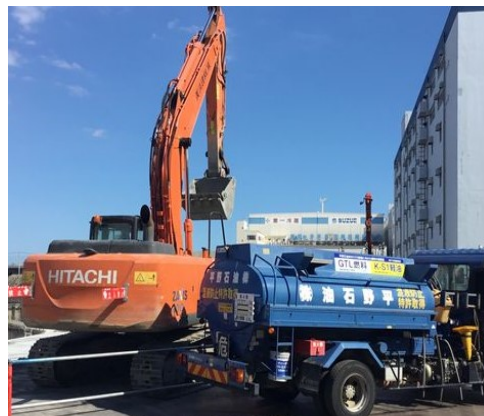
E S R 東扇島ディストリビューションセンター新築工事作業所
