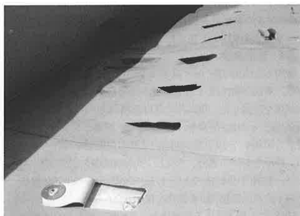
写真 1 機械的固定工法防水システムの台風被害事例
