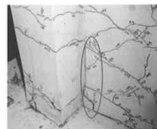
写真 2 ひび割れ状況 (No.2 試験体)
