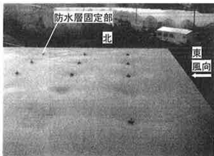
写真 2 防水シートが吸い上げられている状況
