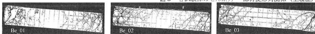
写真1 最終破壊状況
