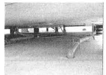
(c) 設備配管
