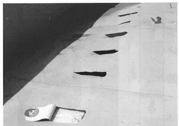
写真 1 機械的固定工法による防水層の台風被害例
