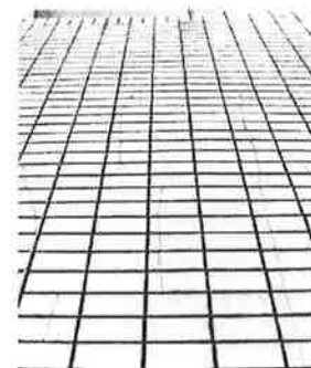
写真1 タイル壁面のひび割れ
