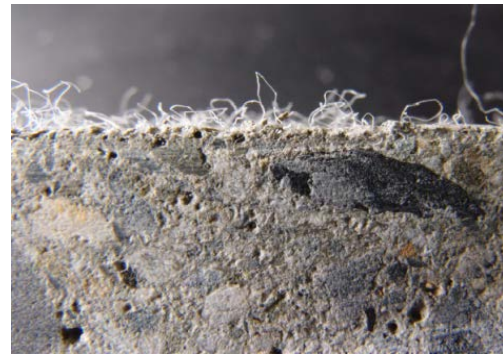
写真4 タイル張り前のコンクリート断面
