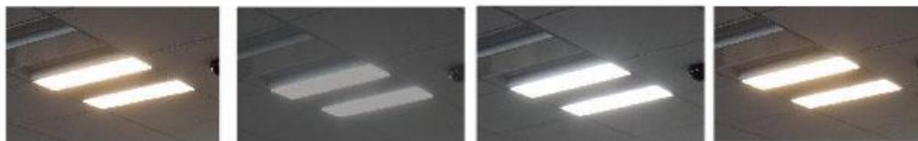
調光・調色型 LED 照明器具 (20 台)
